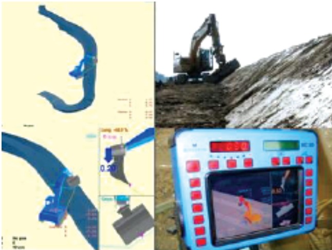
Fig. 7 - Fase di rimodellazione dell'appezzamento con particolare del software montato a bordo dell'escavatore. Fig. 7 - Plot remodeling phase with special software installed on board the excavator.
